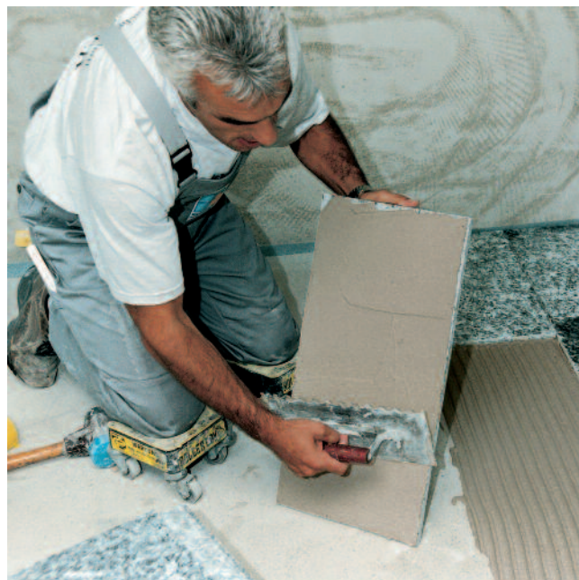
Aby se při pokládce zamezilo tvorbě dutin, nanáší se lepidlo i na rubovou stranu dlažeb i obkladů.
