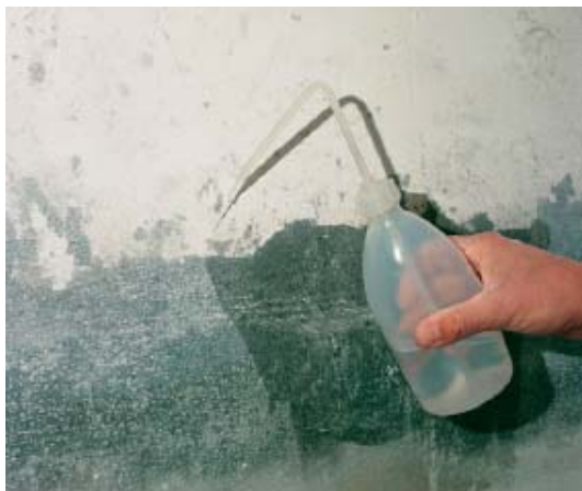
Olejevé znečištění může být ze zdi snadno odstraněno. Nástřik vodou ukazuje penetraci do podkladu a neprojevuje se vodoodpudivost oleje.
