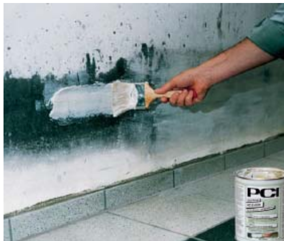
Nanášení čisticího prostředku PCI Entöler na olejem znečištěný podklad, zde olejem znečištěná zeď po povodni.
